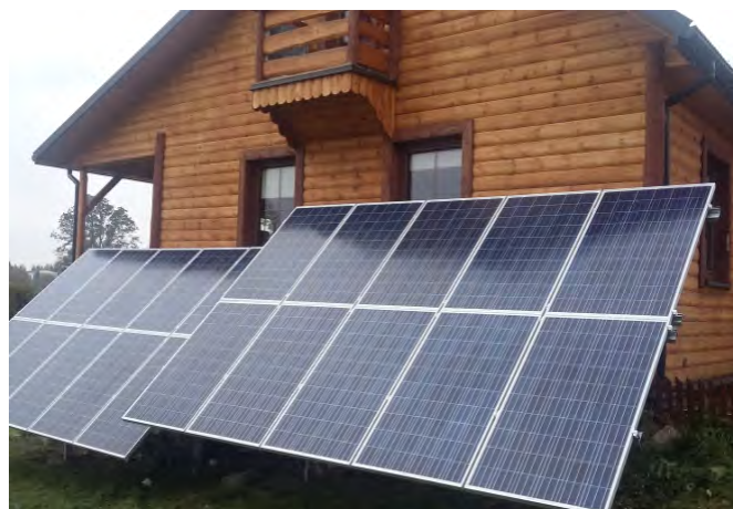
Panele fotowoltaiczne (wykorzystujące odnawialne źródła energii, służące do wytwarzania energii elektrycznej lub ciepłej) na jednej z posesji na terenie gminy Szydłowiec
